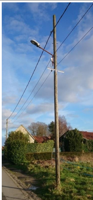
Éclairage public sur support bois commun
