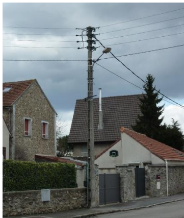
Réseau aérien BT à conducteurs nus sur poteau béton
