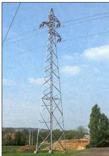
Réseau aérien HTB de 63 kV sur pylône
