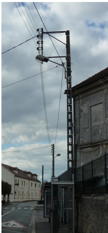
Éclairage public BT sur support béton commun
