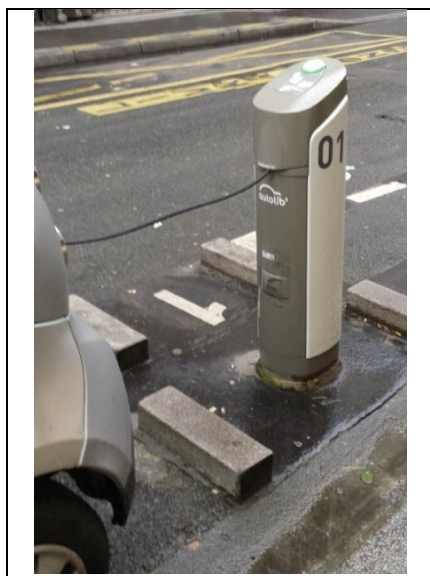
Borne de recharge électrique
