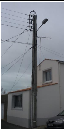
Réseau aérien BT sur support commun
