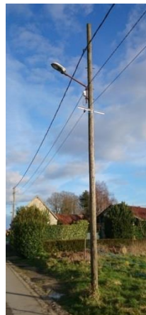
Réseau aérien BT à conducteurs isolés sur poteau bois
