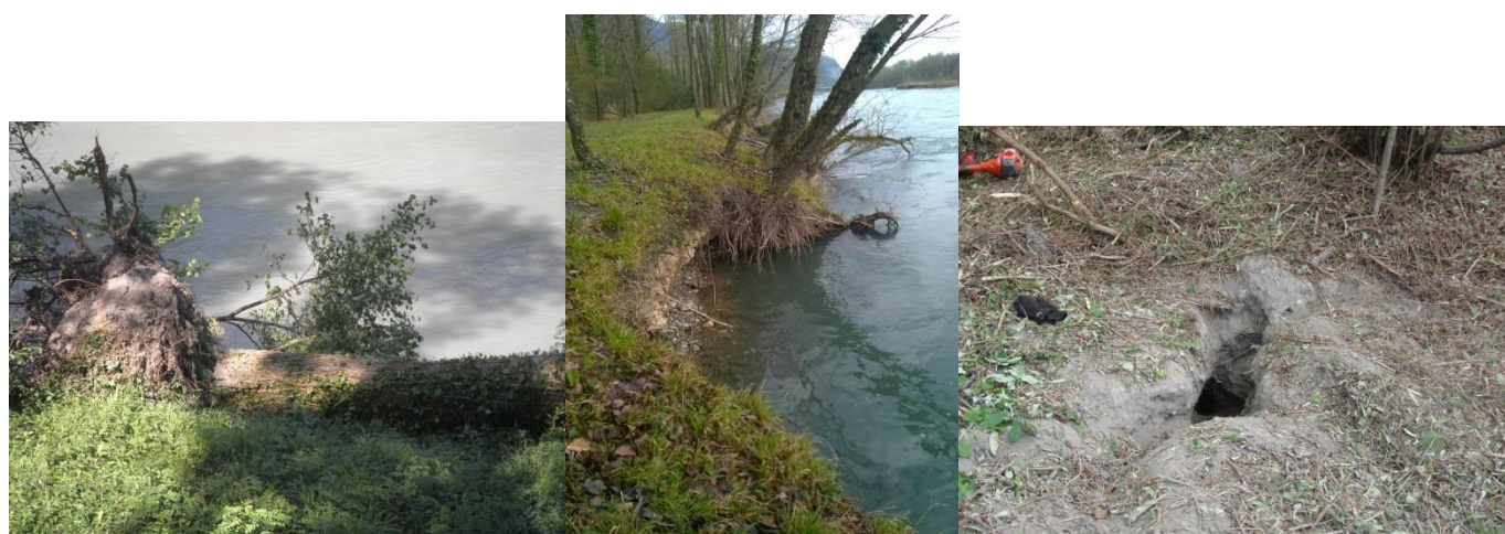
Figure 2 : Exemples de dommages sur digues, dus à la nature (chute d'arbre avec racine, anses d'érosion, terriers de blaireaux)
