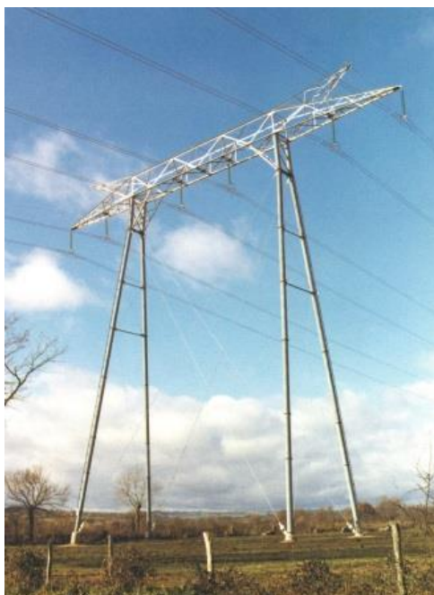
Réseau aérien HTB de 225 kV
