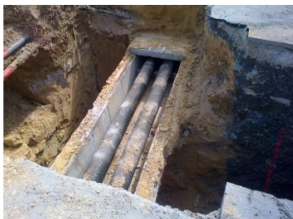
Réseau en caniveau
