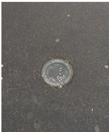
Éclairage par le sol
