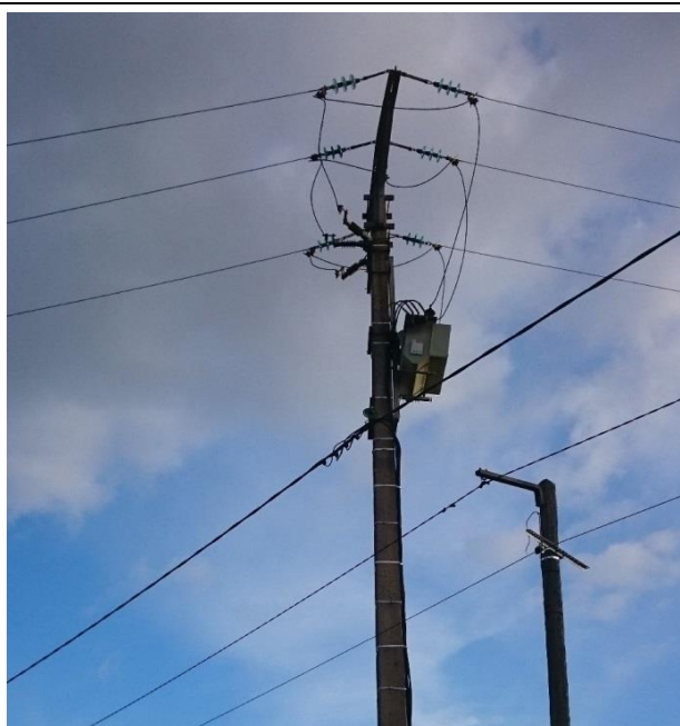
Réseau aérien BT torsadé sur support HTA
