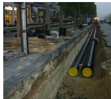
Réseau en pleine terre
