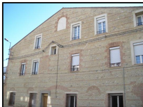
Réseau aérien BT à conducteurs isolés en façade
